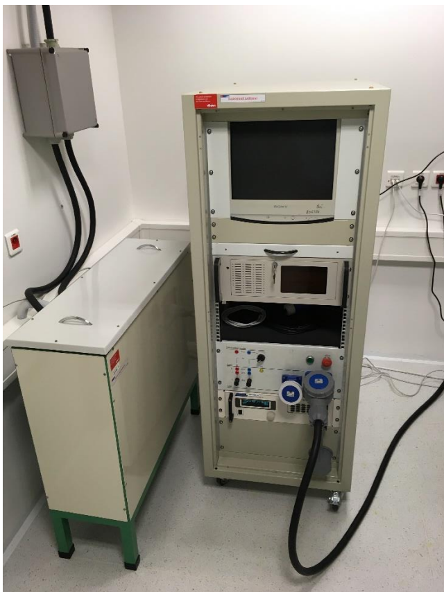
Napájecí zdroje ve statické zdrojovně pro napájení výukových laboratoří Ústavu elektroenergetiky
